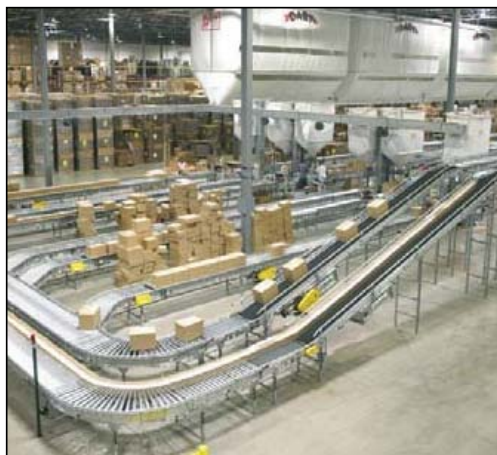
Автоматизированное складское оборудование
